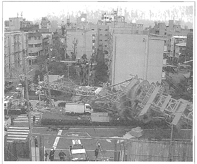
写真—1 平成14年1月、基礎杭が抜けてクレーン本体が転倒
